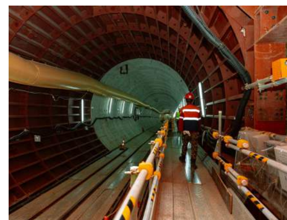
Gambar 15. Pekerja konstruksi melintas di area pembangunan terowongan Stasiun Glodok. Foto oleh PT MRT Jakarta (Perseroda).
